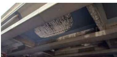
〈콘크리트 바닥판 박락〉
