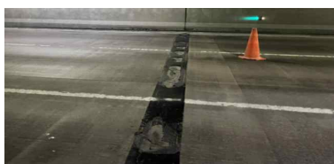
〈지하차도 신축이음부 파손〉
