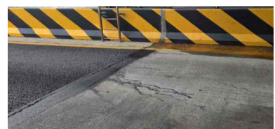
〈지하차도 신축이음부 균열〉
