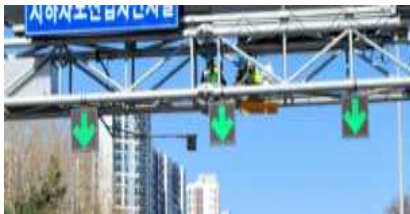
<진입통제 알림용 LCS 설치>
