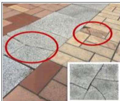
보도블럭 파손 및 침하
