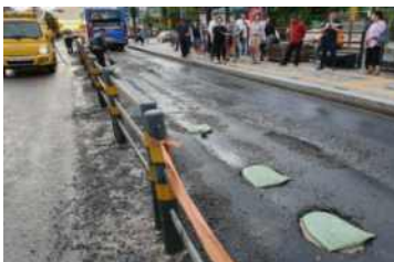
<아스팔트 포장 파손>
