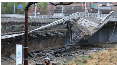
〈점검·관리부실 교량 붕괴〉
