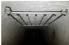
미세 물분사 악취저감시설
