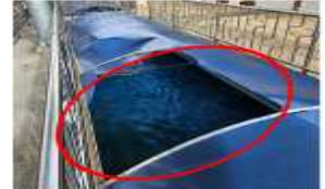
여과지 덮개 파손
