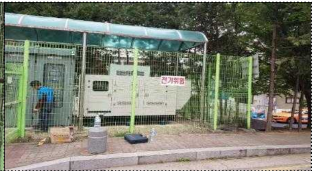
중랑구 신내지하차도 발전기 교체 후
