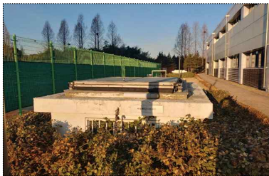
안전시설 미설치(개선 전)
