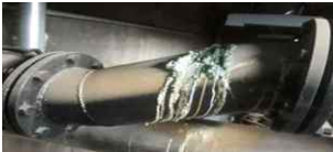
<공동구 노후 배관>
