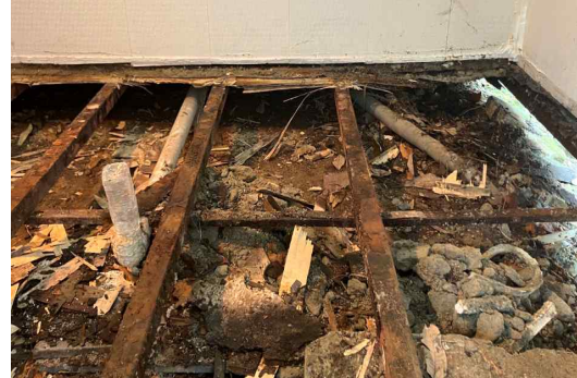
〈바닥공사 미비로 인한 노후화〉
