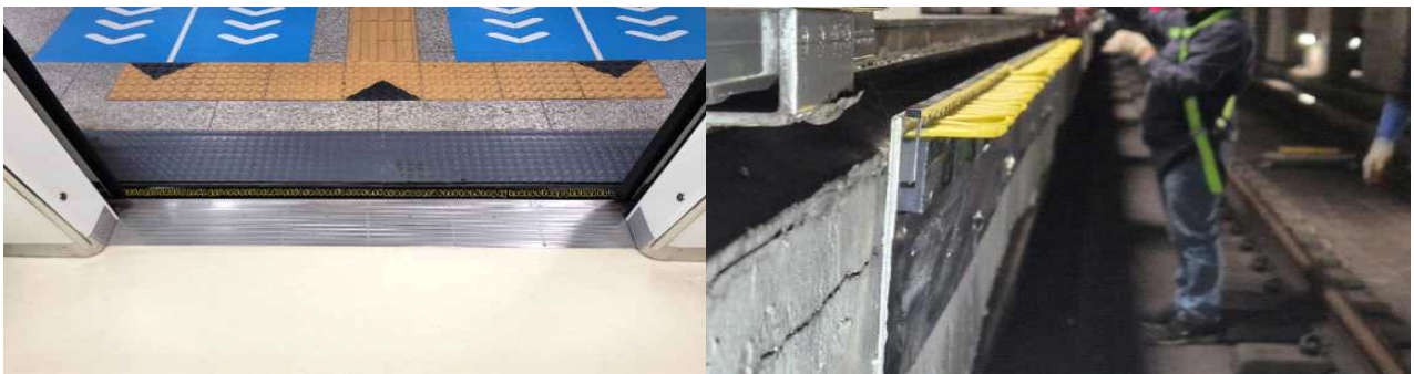
< 승강장 유실물 방지망 설치 상태 >
