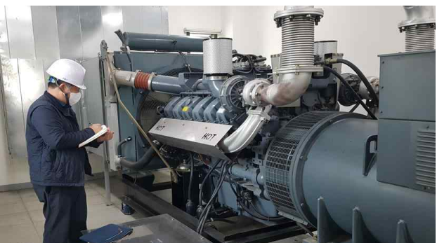
〈송파구 위례중앙지하차도 배수펌프 점검〉
