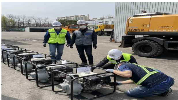
〈배수펌프 가동상태 점검〉
