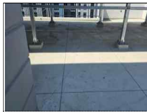
(사례) 균열(옥상 바닥)
