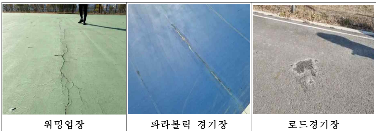
〈 이촌 인라인롤러스케이트장 바닥 포장면 파손 모습 〉
