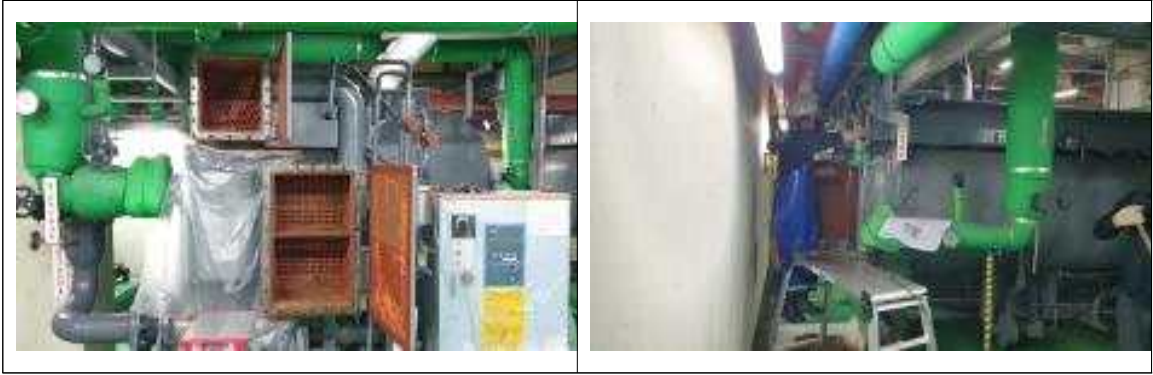
[종로5가 지하도상가 흡수식냉온수기 설치 현황]
