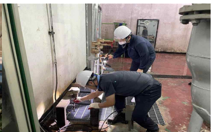
<배수펌프 점검 및 시운전>
