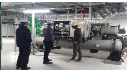
<냉방설비 가동상태 점검>
