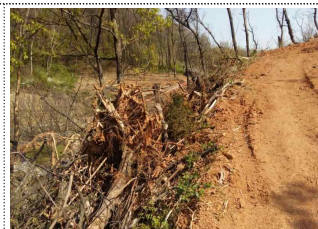
임야내 불법 임도 설치
