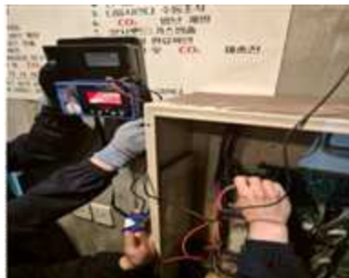
【분전반 절연저항 측정】
