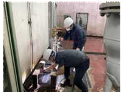
【배수펌프 점검 및 시운전】
