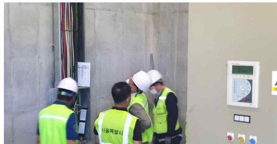
〈서초구 내곡지하차도 기전시설 점검〉
