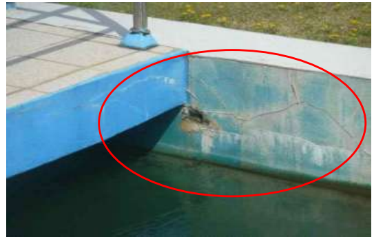
[ 균열 및 콘크리트 벽면 탈락 ]
