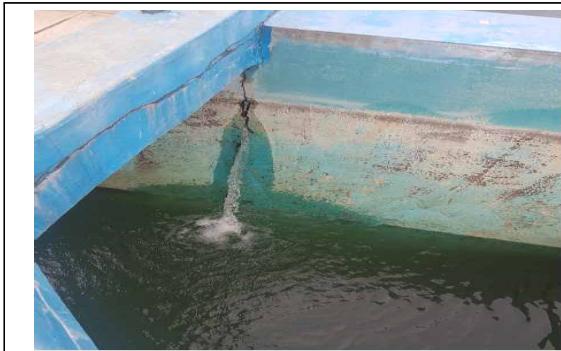
[ 균열 부분 누수 발생 ]
