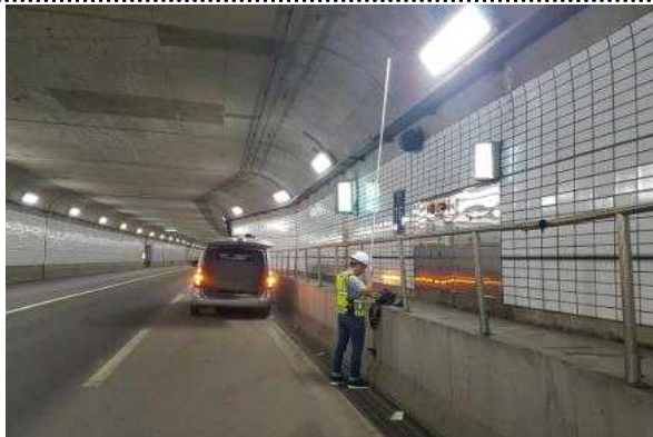
〈 위례터널 라디오 재방송설비 유지보수 〉
