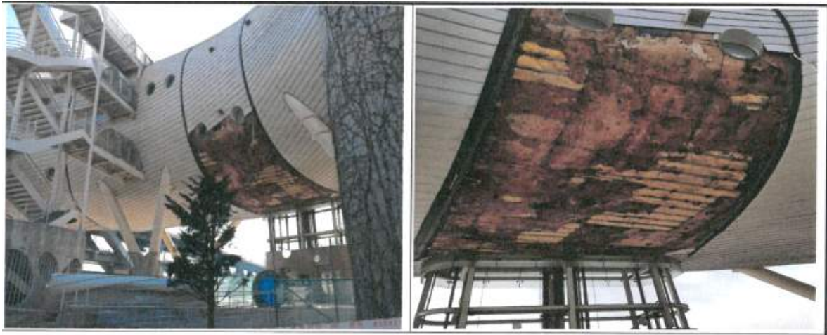
그림 2. 외장재 탈락 구간 전경 사진
