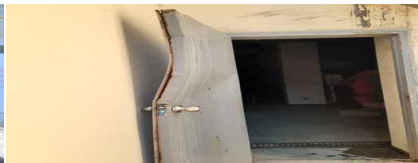
〈출입문 파손(#1소화조 4계열)〉
