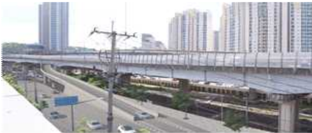
내부순환로 월곡IC 구조개선
