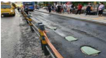
<아스팔트 포장 파손>
