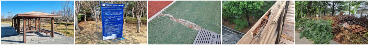
파고라 지붕 파손 주차장 안내판 파손 바닥포장 파손 보도육교 파손 입목폐기물 방치
