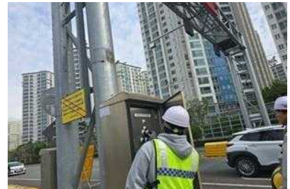
〈신답지하차도 진입차단시설 점검〉
